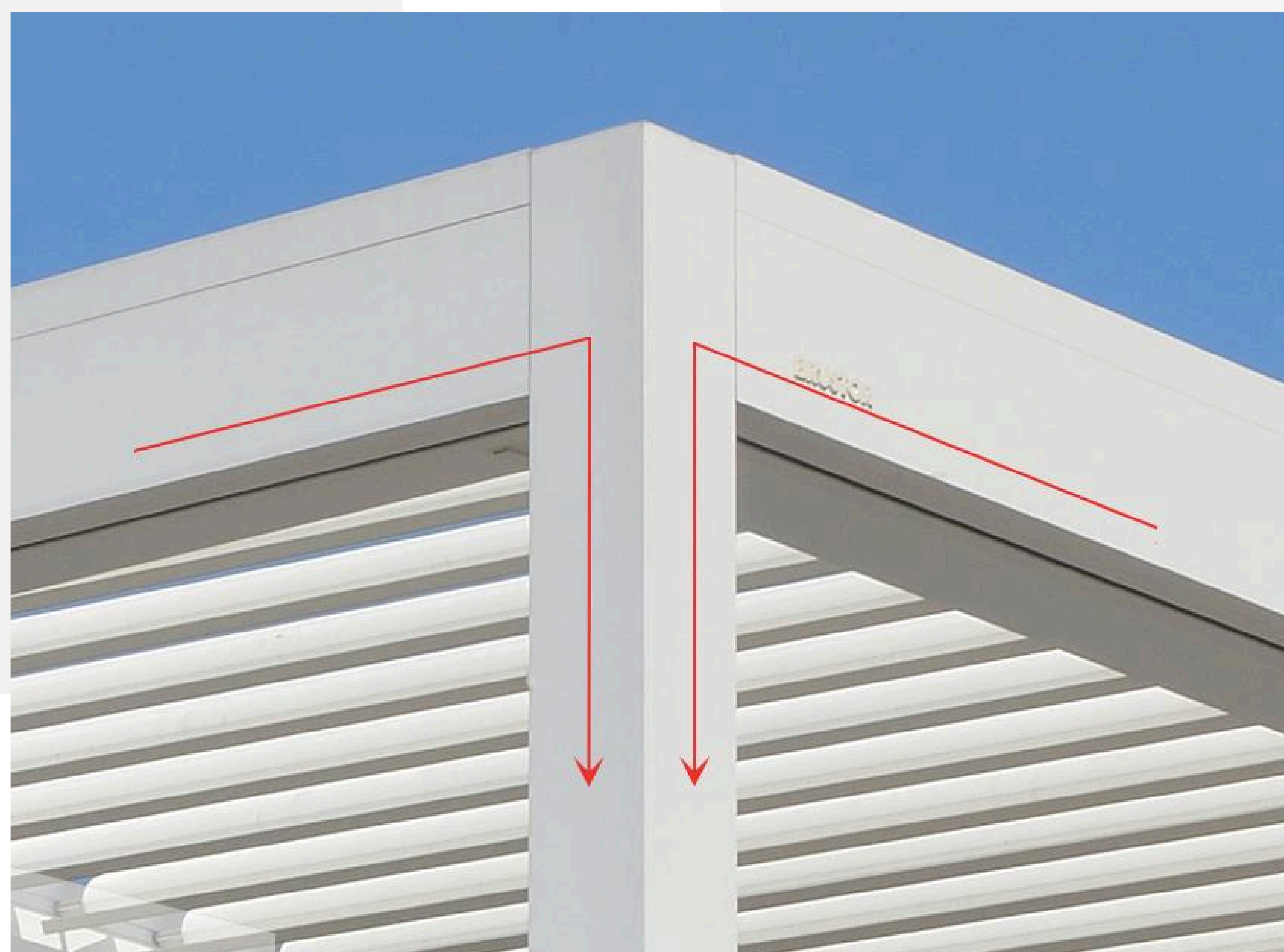
Canalón perimetral con evacuación por el interior de los pilares
